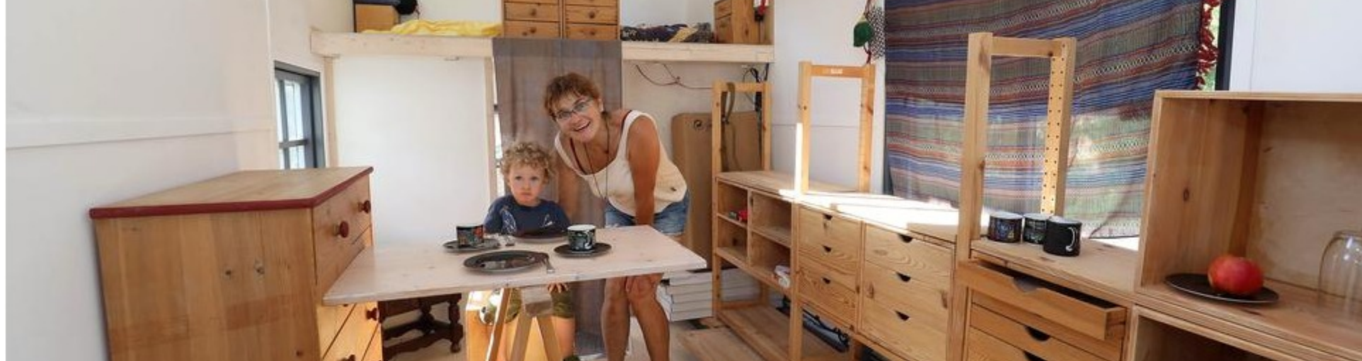
Möbel-Recycling: Kathi verwendet in ihrem Tiny House die Holzregale aus ihrer alten Wohnung für die Küche. Enkel Eliah begutachtet den Fortschritt des Innenausbaus. Foto: Jörg Donecker
